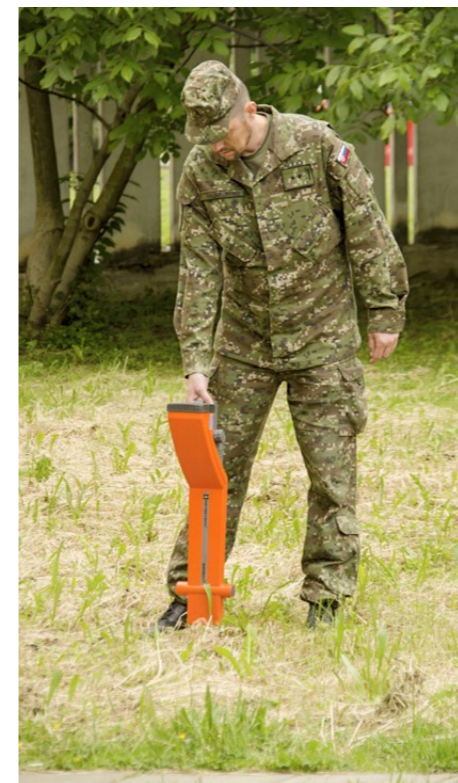
Zameriavanie poškodenia zemného kábla
